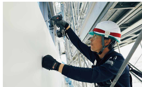
完成後の瑕疵で一番多いのが雨漏り。だから外装は確かな仕事が必要。
